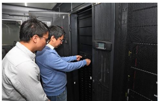
技术人员正在紧张调试
